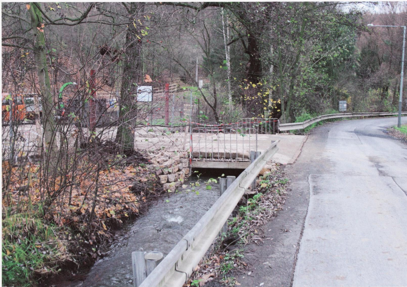
Příloha 25: Mostek na stavbu – brání průtoku při zvýšené hladině potoka, voda se rozlévá do vozovky
